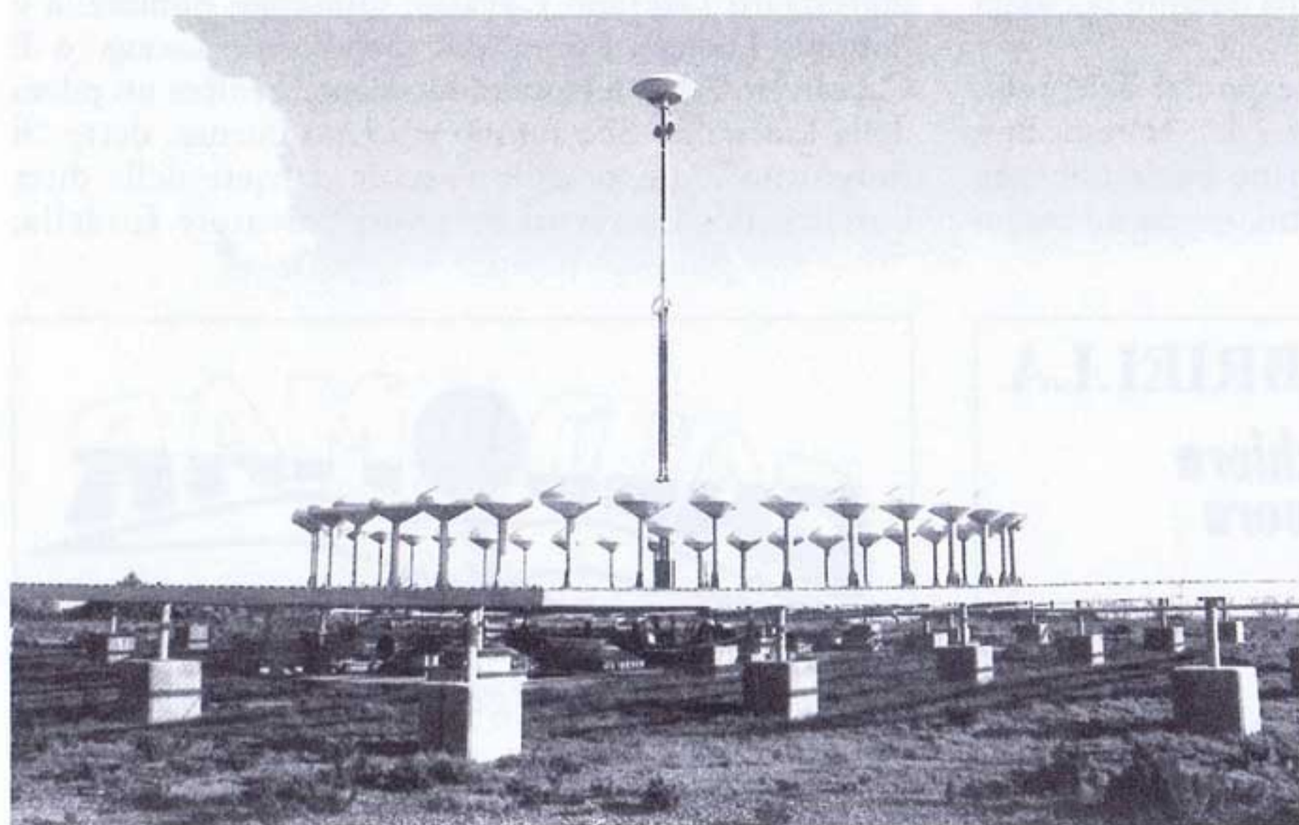
Teleposto di Monte Calamita. L'antenna degli apparati per la navigazione aerea. Alta circa 8 metri, fornisce agli aerei l'esatta posizione delle apparecchiature a terra.
